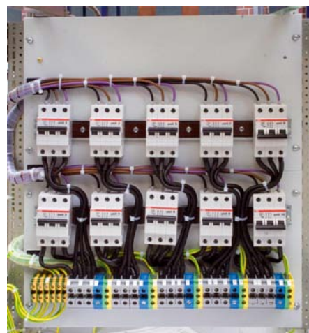
AC вход с авт. выключателями AC input panel with breakers
