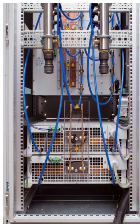
Смешанная система с водяным охлаждением Mixed system with water cooling
